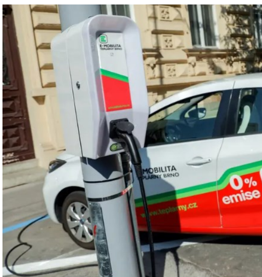
Obr. 14 Nabíjecí stanice na stožáru VO v Brně
