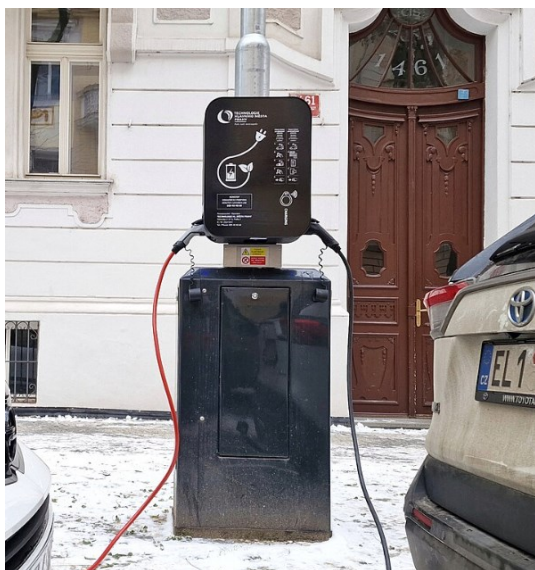
Obr. 13 Nabíjecí stanice na stožáru VO v Praze
