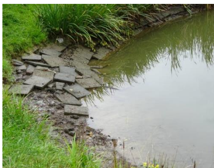
Stav návodní strany hráze před opravou
