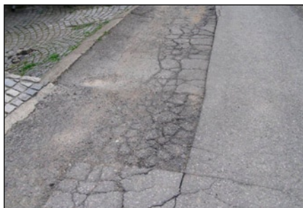
pohled na část ulice Pod Hvězdárnou před opravou
