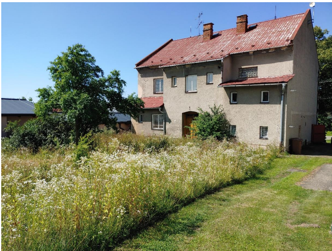
Značně opotřebená budova bývalé školy a neudržovaná zahrada
