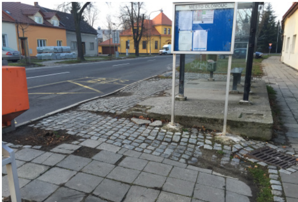
U autobusové zastávky Na rohu by měla být v případě příznivého počasí ještě do konce roku provedena oprava povrchu a vyrovnání nerovností. Foto: Bohumil Šíp
