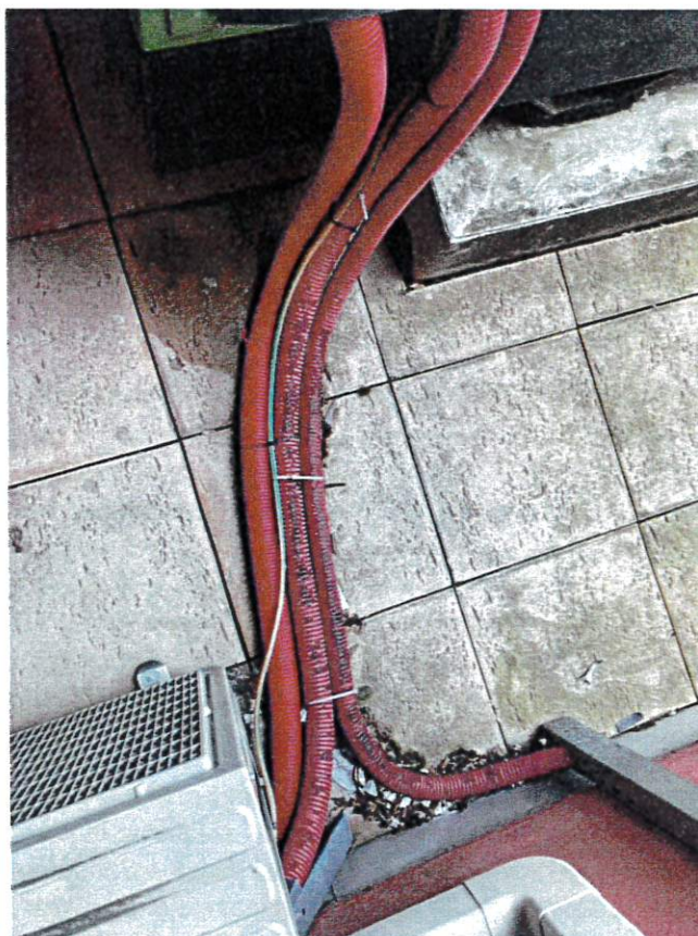
Vedení k jednotce VZT je v chrániče, která neodolává UV záření a tak dochází k její degradaci
