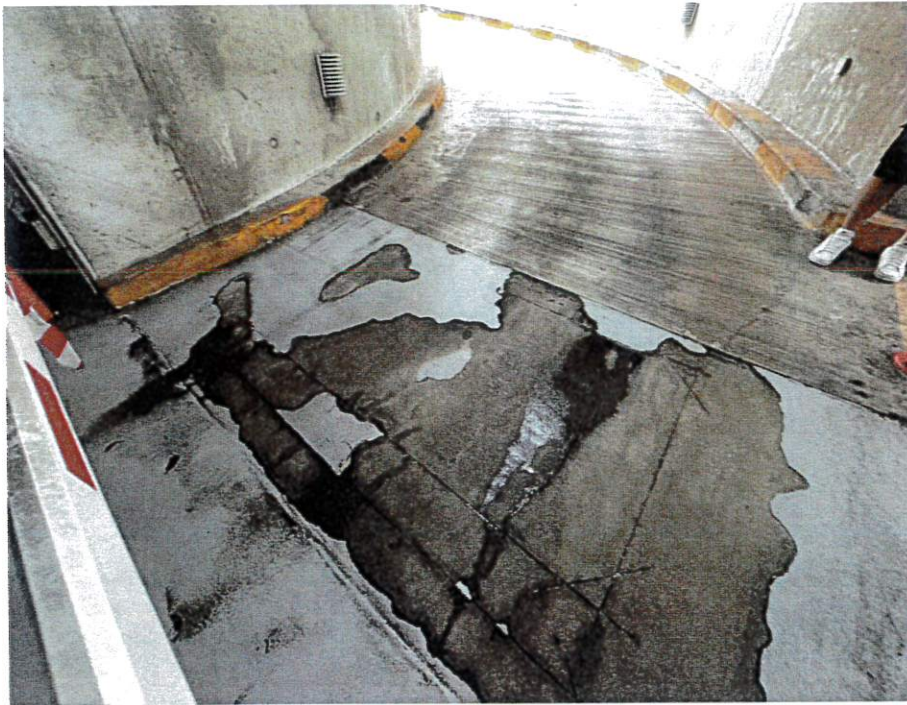
Průsak podzemní vody na přechodu mezi rampou a podlahou podzemních garáží v -1.NP
