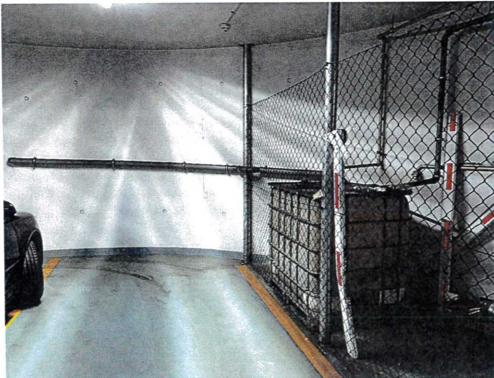
Přečerpávací zařízení srážkové vody z rampy
