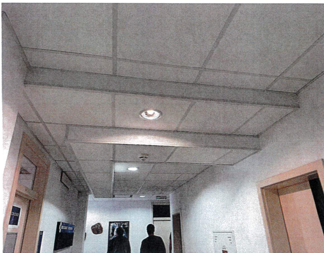
Detail doplnění odvodu kondenzátu od VZT nad podhledem v chodbách – odstraněná příčina zatékání do podhledů na chodbách
