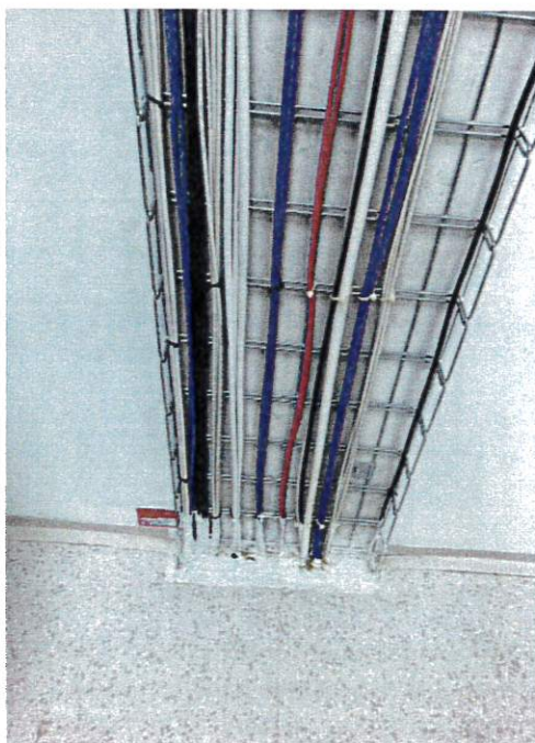
Vedení jednotlivých kabelů je přehledné, dobře uchycené, požární ucpávky jsou revidovány
