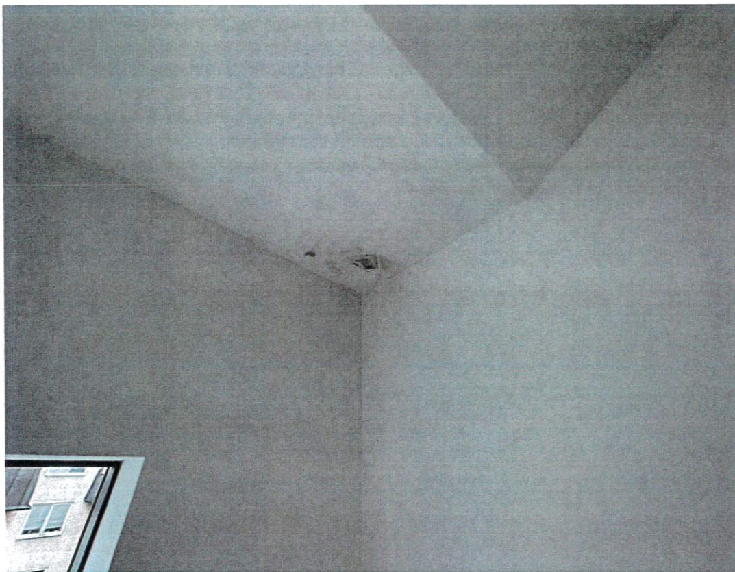
Zatečení do interiéru z důvodu absence údržby na střeše
