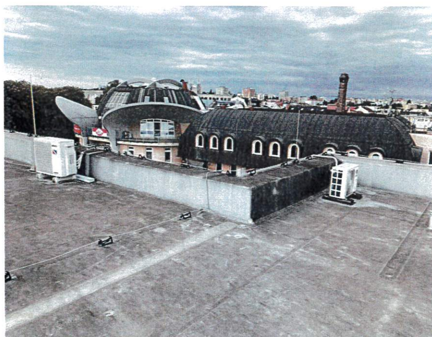
Vedení ze vzduchotechniky křížuje vedení jímací soustavy
