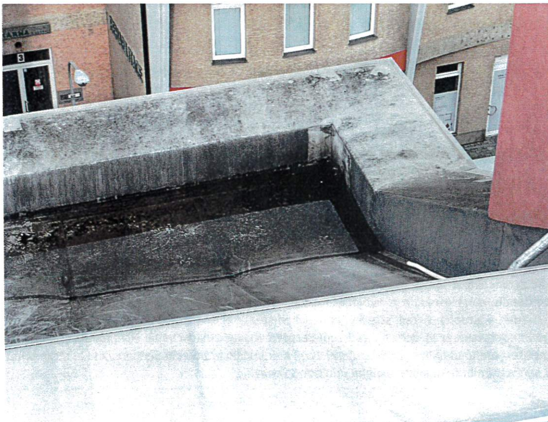
Detail atiky nad schodištěm se zadržanou vodou s následným zatečením do interiéru
