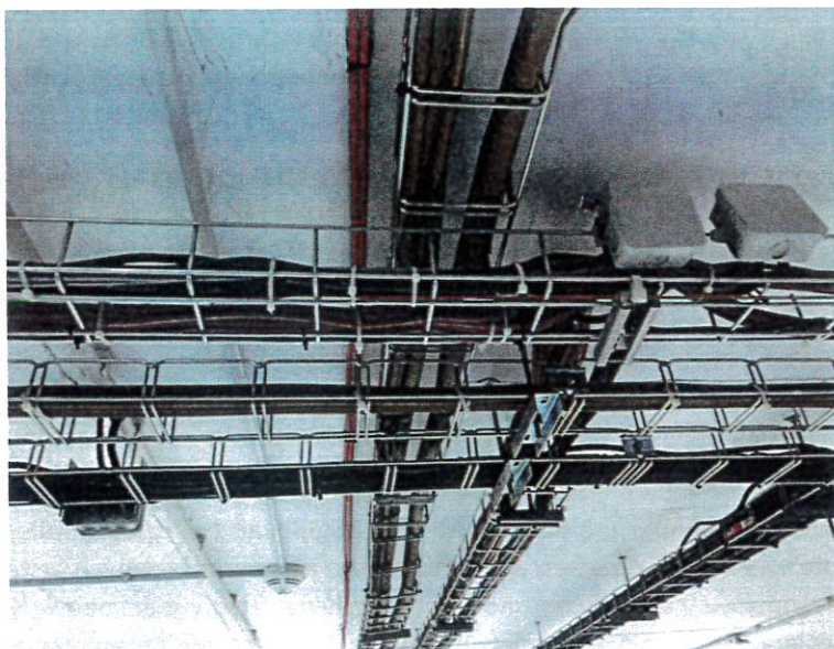
Vedení k jednotce VZT je v chrániče, která neodolává UV záření a tak dochází k její degradaci
