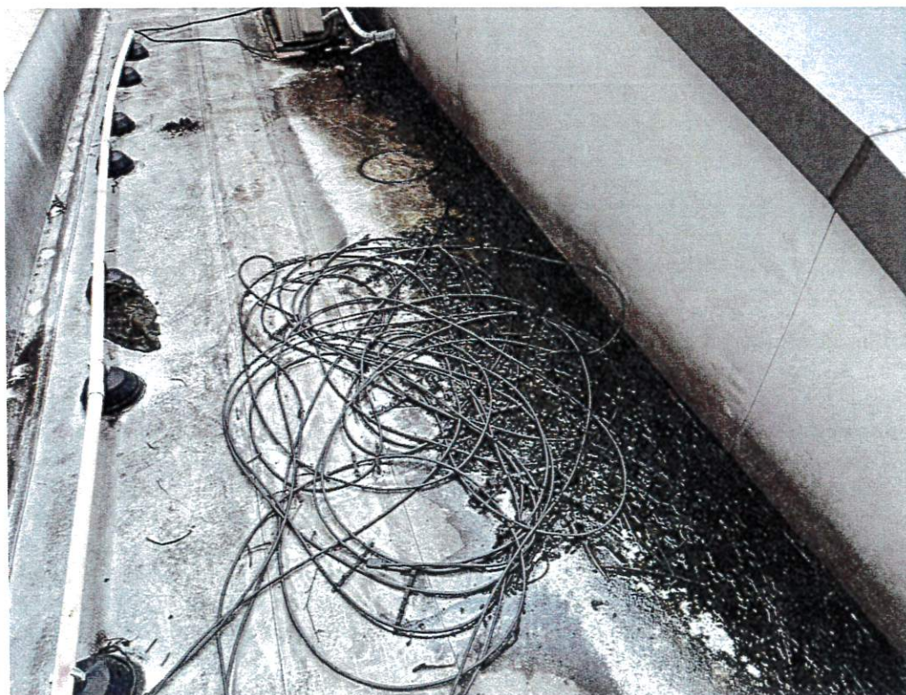
Neudržované plochy střechy pasáže – pohozená kabeláž
