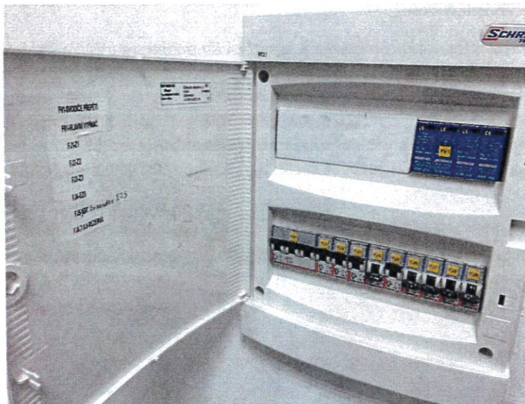
Rozvaděče daných prostor – řádně popsány, rok výroby 2012, přehledné zpracování i s volnou kapacitou
