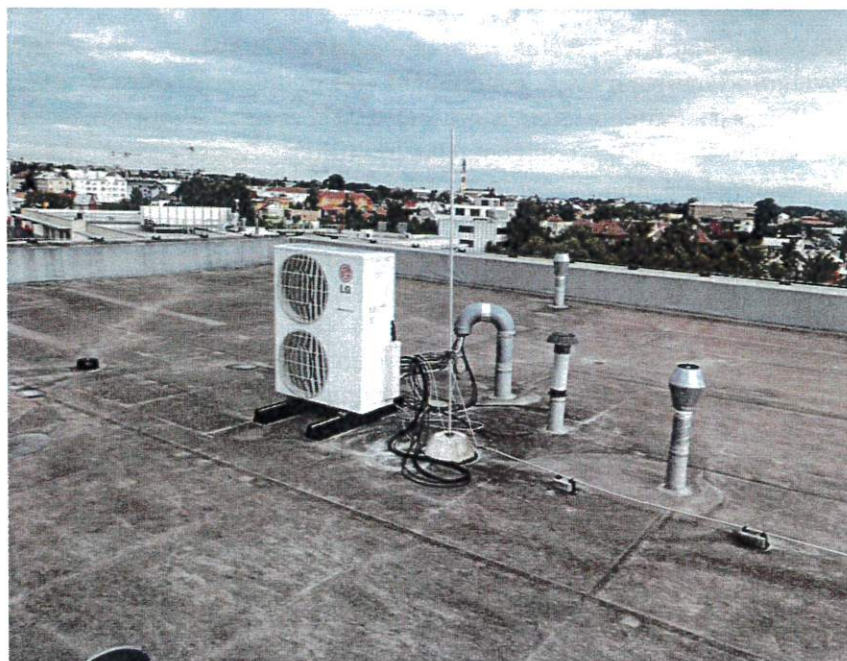
V okolí vzduchotechniky jsou umístěny neznámé kabeláže, které jsou blízko jímací soustavy
