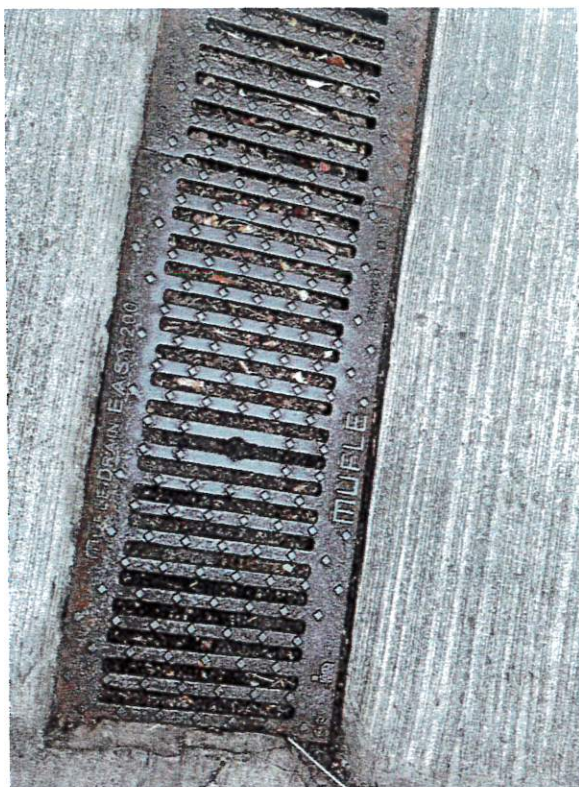
Zanedbaná údržba v konečném důsledku způsobuje poruchy stavby
