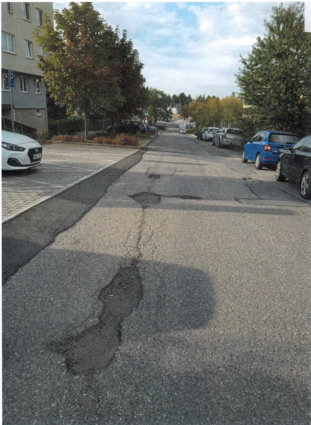
Parc. č. 185/330, k. ú. Nová Ulice, rozbitá komunikace
